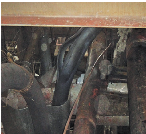
Рис. 32. Разрушениегиба паропровода к турбоагрегату на дроссельной площадке ТЭЦ-4 ООО «Автозаводская ТЭЦ»
