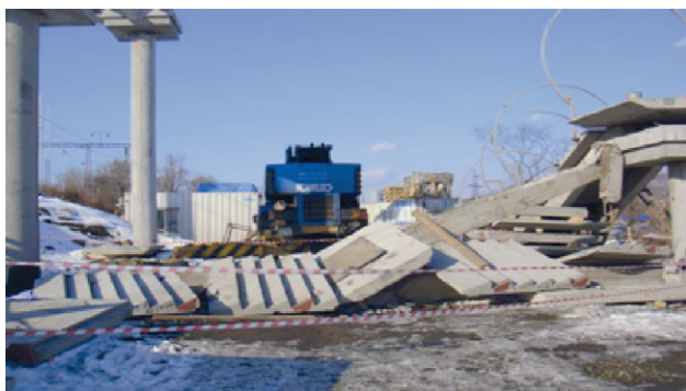
Рис. 83. Обрушение железобетонных конструкций на объекте капитального строительства «Строительство пешеходного моста на станции Смоляниново Дальневосточной железной дороги»
