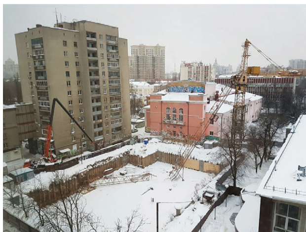
Рис. 51. Излом металлоконструкций стрелы автомобильного крана на площадке строительства при наращивании стрелы башенного крана
