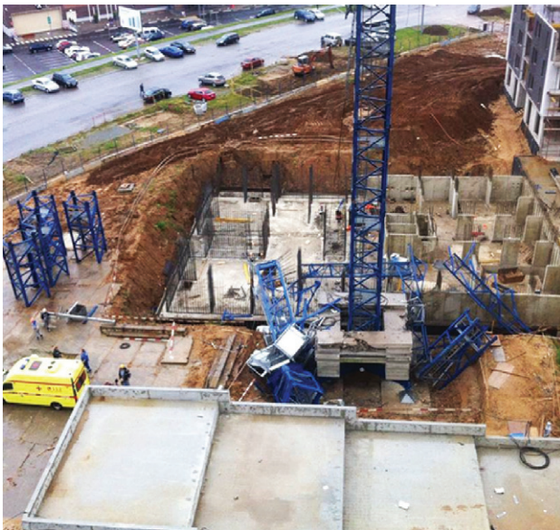
Рис. 57. Обрушение металлоконструкций, верхней поворотной части башенного крана в момент операции наращивания секций башни крана на площадке строительства
