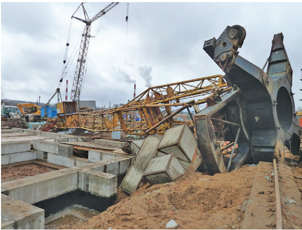
Рис. 52. Падение башенного крана на строительной площадке жилого дома
