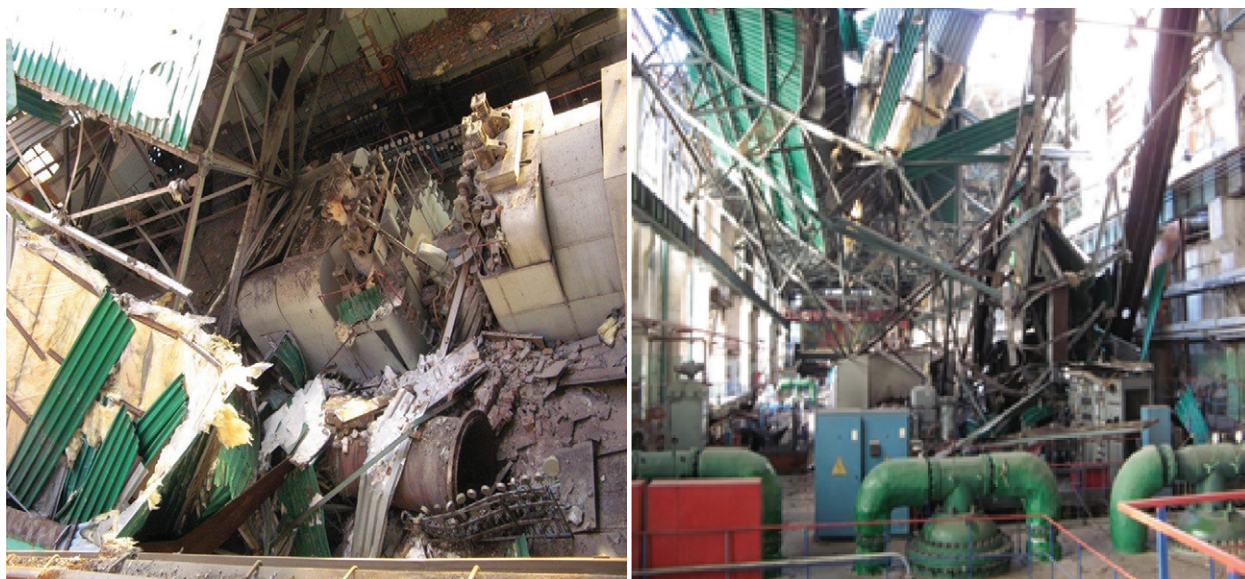
Рис. 31. Авария при проведении гидравлического испытания подогревателя высокого давления ПВД-6 турбогенератора ТГ-5 в турбинном отделении котлотурбинного цеха Пензенской ТЭЦ-1 ПАО «Т Плюс»
