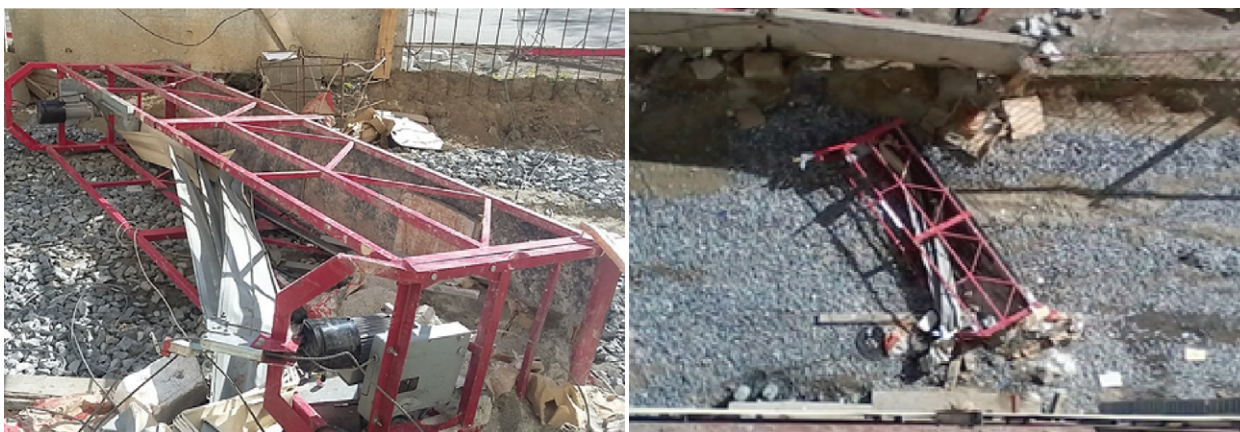
Рис. 54. Падение подъемника с человеком в люльке на строительной площадке жилого дома
